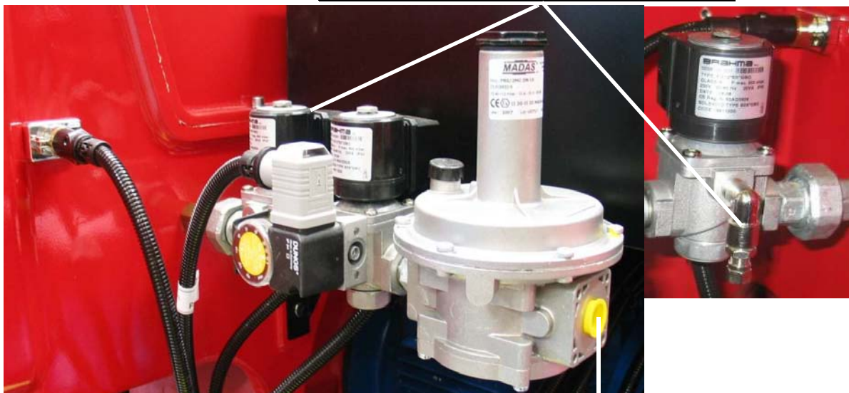
collegamento alla rete distribuzione del gas
