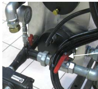
Открытие подачи мазута на форсунку
