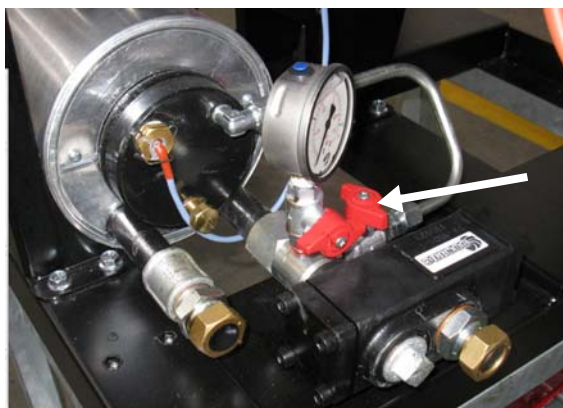
Открытие подачи мазута на форсунку
