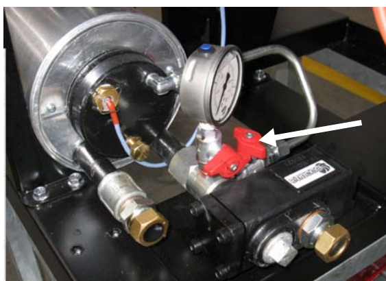
Открытие подачи мазута на форсунку
