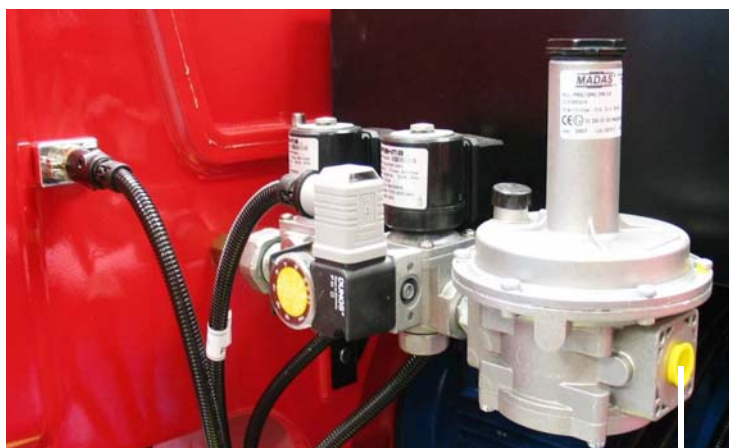
conexión a la red distribución del gas - 1/2"
