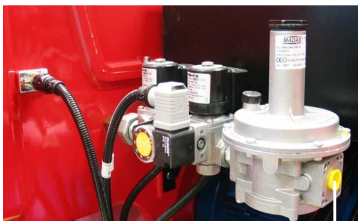
conexión a la red distribución del gas - 1/2"
