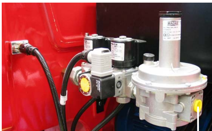
conexión a la red distribución del gas - 1/2"
