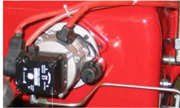
насос дизельной запальной горелки
