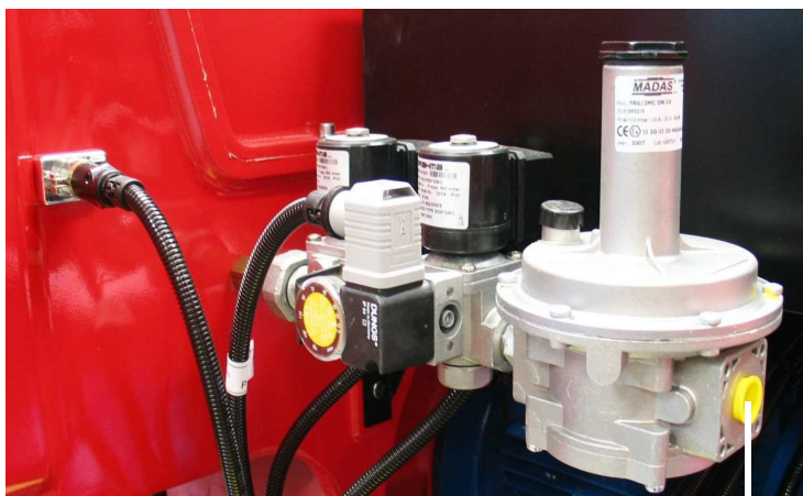
collegamento alla rete distribuzione del gas - 1/2"
