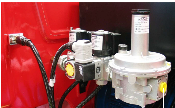
collegamento alla rete distribuzione del gas - 1/2"
