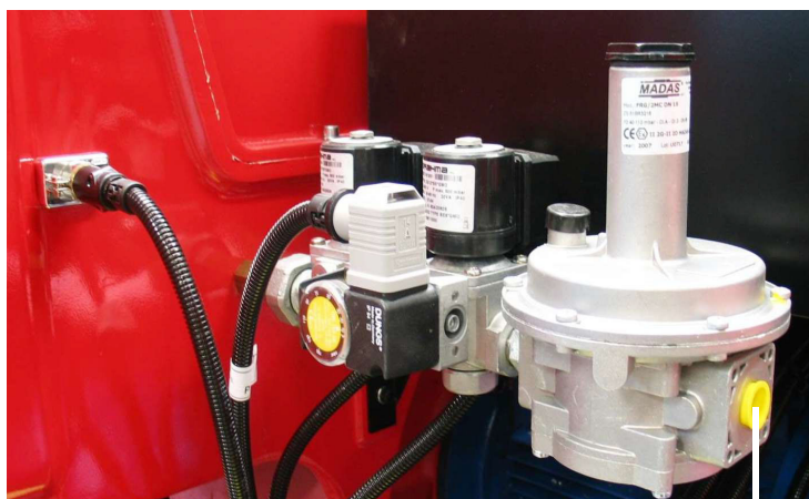
collegamento alla rete distribuzione del gas - 1/2"
