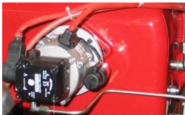
насос дизельной запальной горелки
