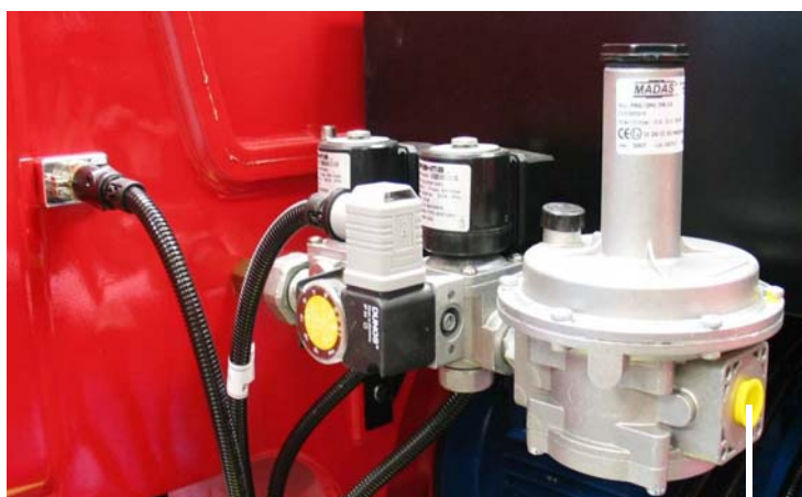
collegamento alla rete distribuzione del gas - 1/2"
